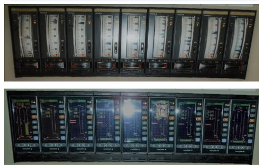
パネル計器の更新
